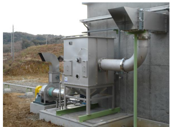
密閉試験場の排ガス処理設備
